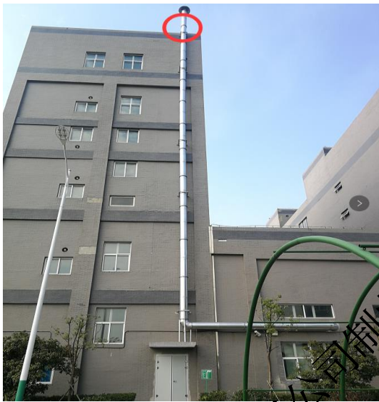
整改后颗粒物排气筒采样口
