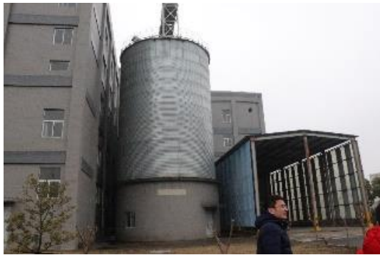
整改前原料筒仓（未密封收集颗粒物）
