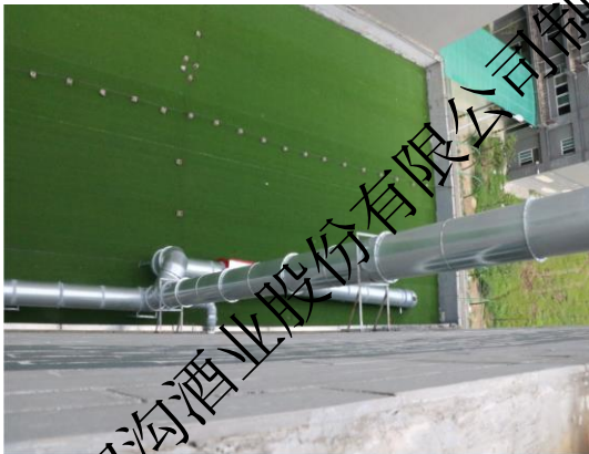
整改后颗粒物收集输送管道
