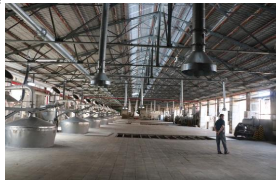
218 酿酒车间废气收集措施
