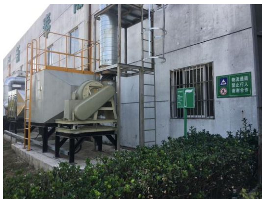
218 酿酒车间废气标识牌 (1#)
