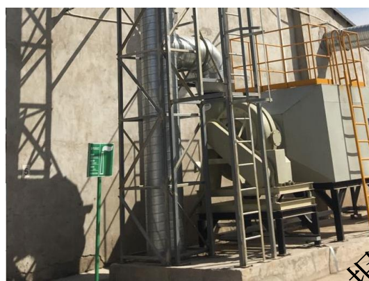
218 酿酒车间废气标识牌 (2#)
