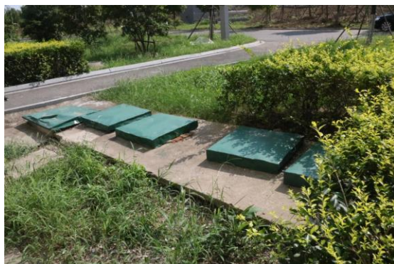
制曲车间化粪池
