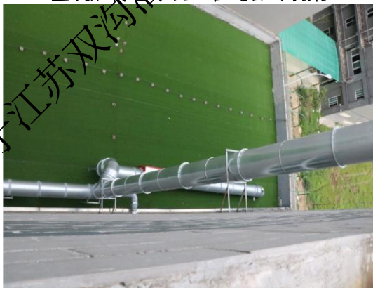
整改后颗粒物收集输送管道
