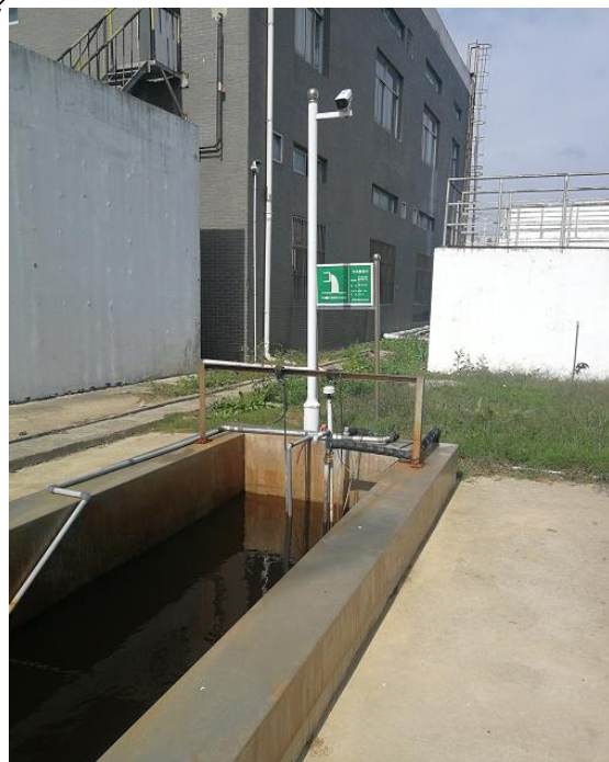
新区污水处理站排水口
