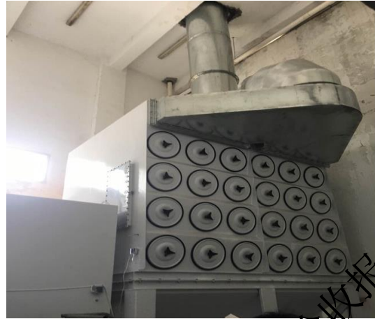
整改后初效+中效+高效除尘设施
