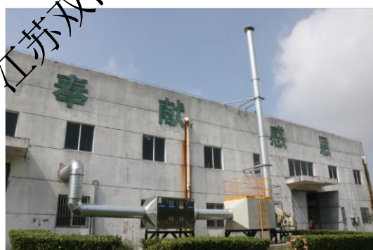
218 酿酒车间废气治理措施 (1#)
