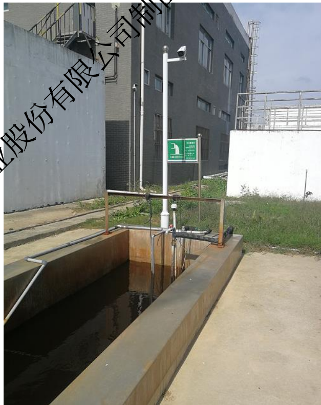
新区污水处理站排水口
