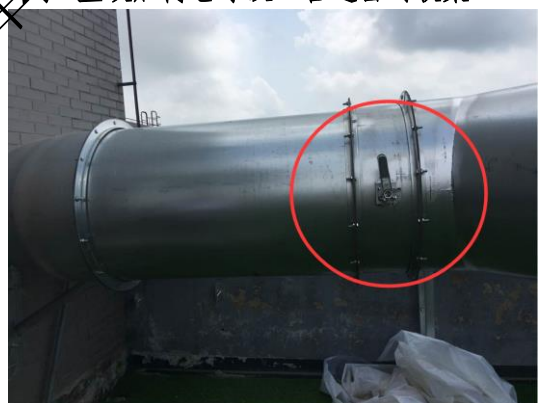
整改后颗粒物废气控制阀（针对筒仓）
