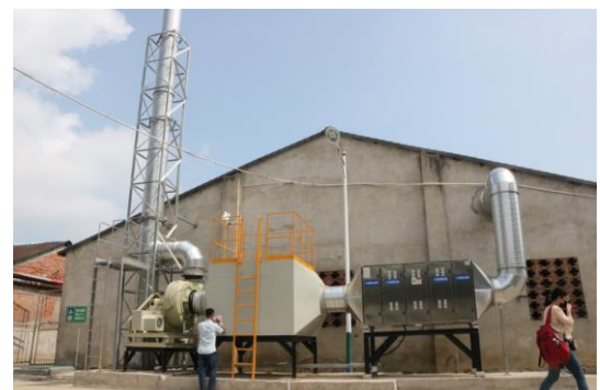
218 酿酒车间废气治理措施 (2#)
