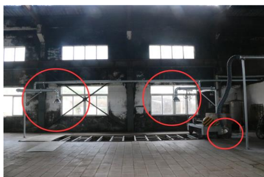
218 酿酒车间废气收集措施
