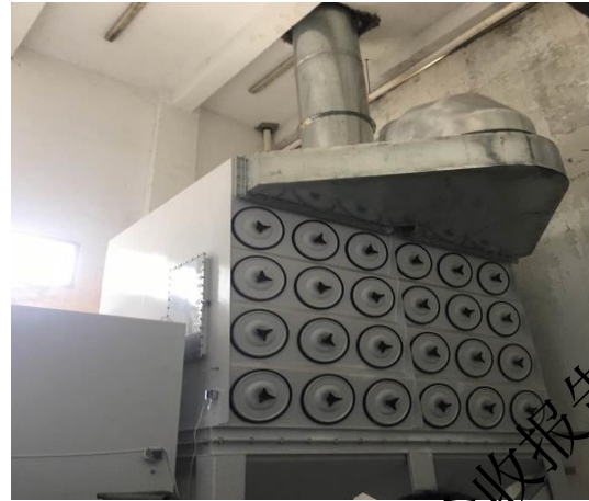
整改后初效+中效+高效除尘设施
