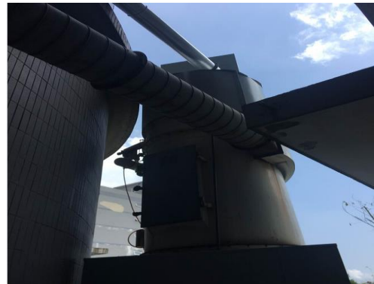
整改后原粮输送及除杂旋风除尘器
